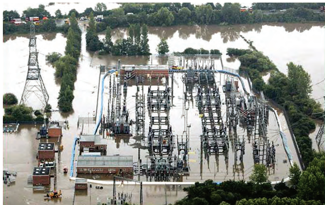
Наводнена електрическа подстанция
